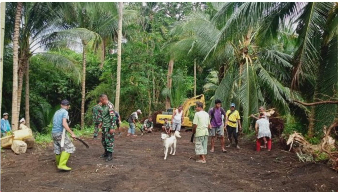
Warga berbaaur bersama Satgas TNND Ke-116 Kodim 1310 Bitung dalam kerja Pembangunan Jalan Pertanian
